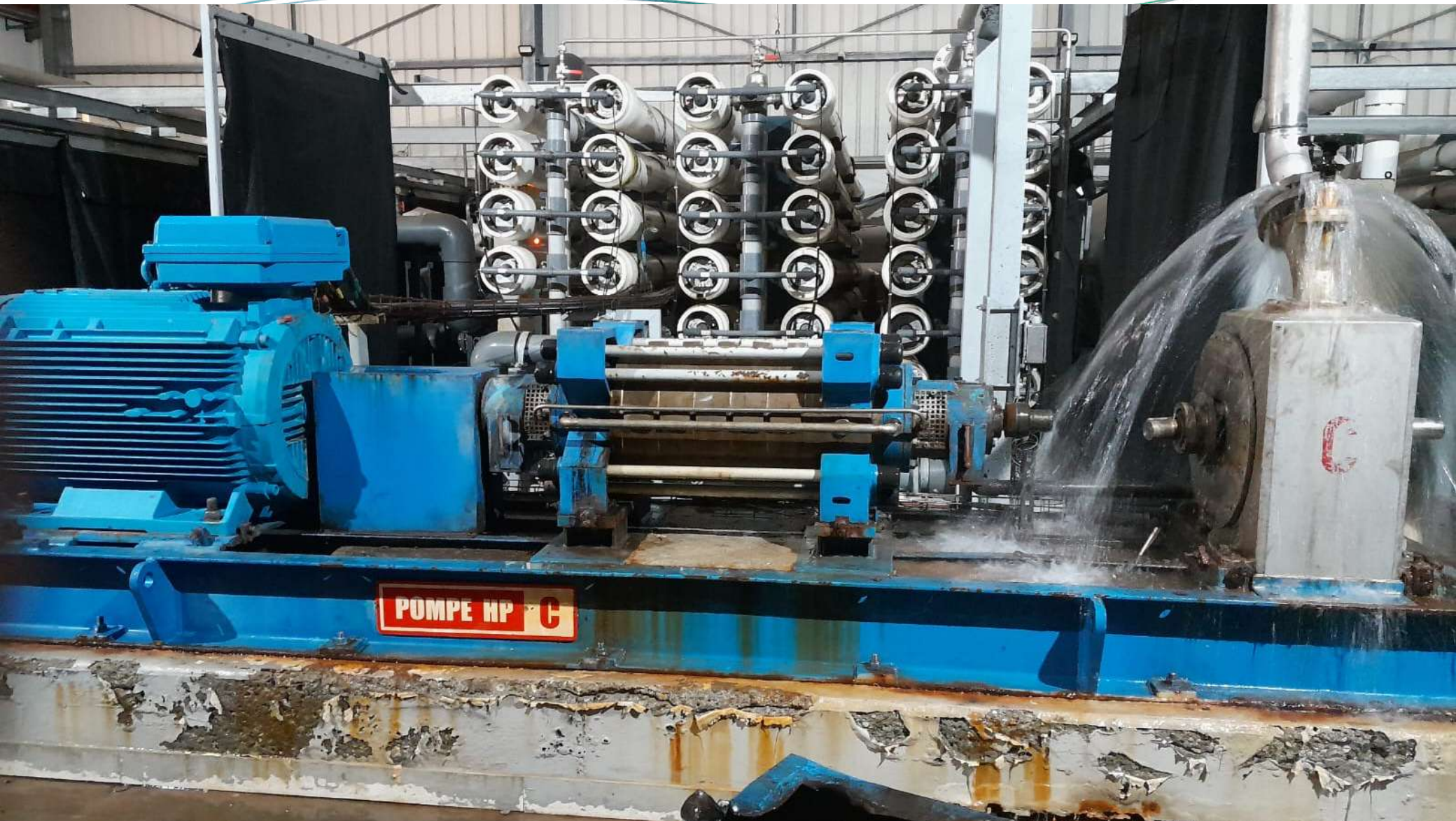
Usine de production d'eau potable dans un état de dégradation avancée
